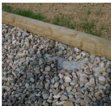
Tuyau d'arrivée sur le filtre à écoulement horizontal, recouvert de galets (pour la photo, le tuyau est légèrement découvert ; en temps normal, il n'est pas visible)
