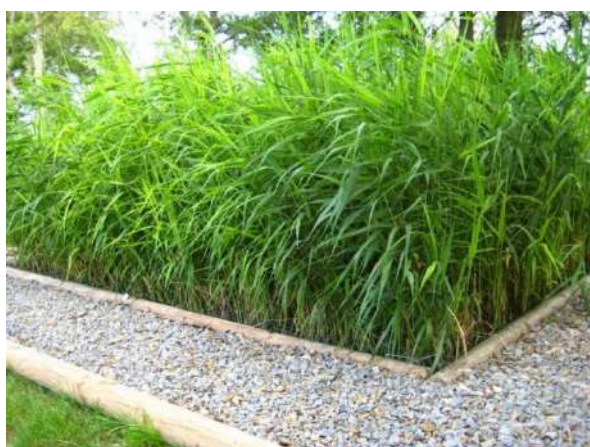
Filtre à écoulement vertical en saison végétative (la grille est camouflée par les roseaux)
